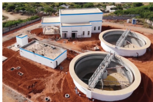
安哥拉罗安达甘德拉布罗水厂三期项目 - 污泥处理站
